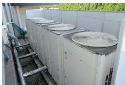
室外機用防音対策
