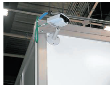
倉庫内の赤外線カメラ設置 (防犯セキュリティシステム)
