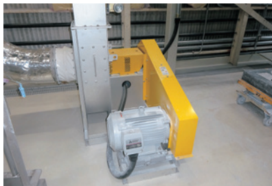
施工前ポンプ
