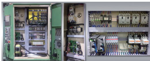
制御盤レトロフィット後
